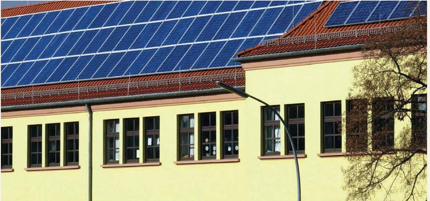
12 t CO 2 /Jahr werden durch die neue Photovoltaikanlage auf der Pestalozzi-Schule in Rohrbach eingespart. Sie kann durchschnittlich 4 Haushalte/ Jahr mit Strom versorgen.
